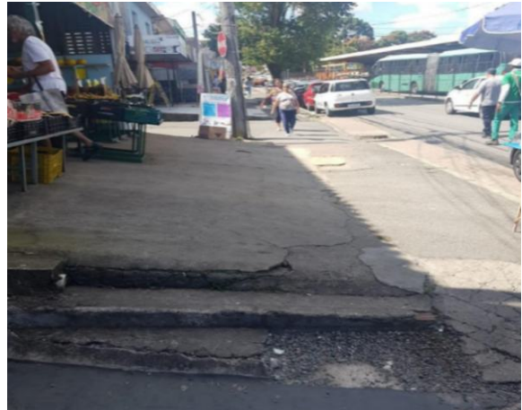
Figura 12 - Rua Padre Gaston (pavimento danificado)
