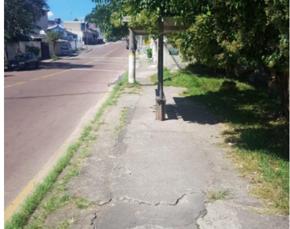
Figura 10 - Rua Izzalino Buozzi (pavimento danificado)
