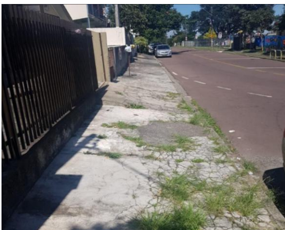
Figura 11 - Rua Lea Moreira de Souza Moura (pavimento danificado)
