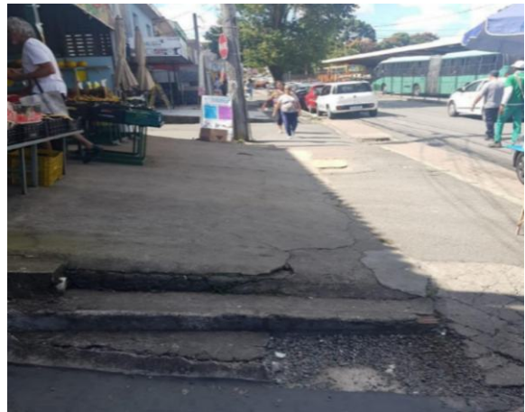
Figura 12 - Rua Padre Gaston (pavimento danificado)
