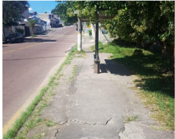
Figura 10 - Rua Izzalino Buozzi (pavimento danificado)
